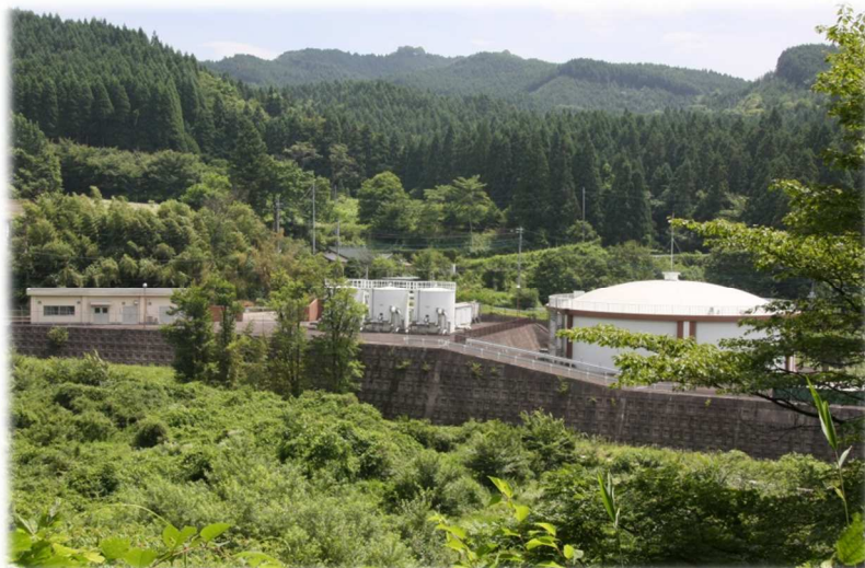
一ノ瀬浄水場
