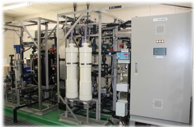
西野牧浄水場膜ろ過装置
