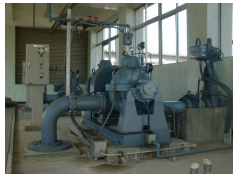
人見送水ポンプ3号
