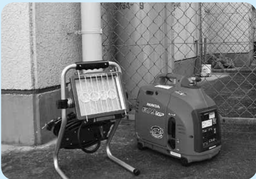
災害対応設備のLPガス発電機と投光器
