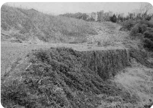
下秋間太陽光発電所北のり面の『緑のダム』
