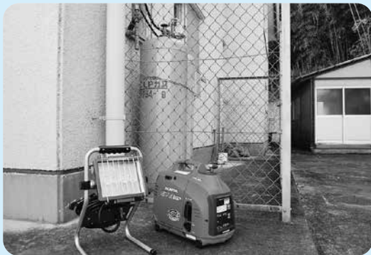
設置しつつあるLPガス発電機と投光器
