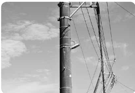
市内の防犯灯
