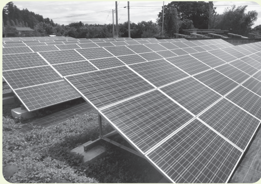
増えている太陽光発電所
