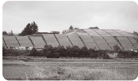
メガソーラー発電所
