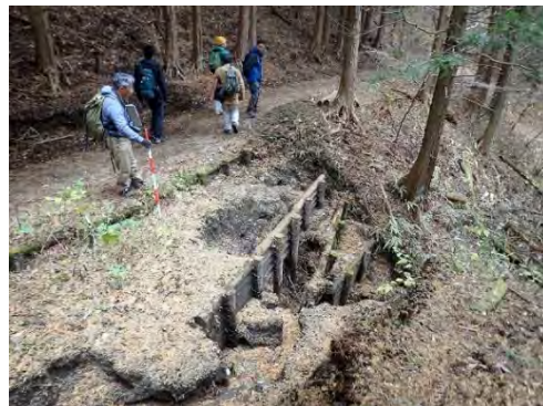
→現在は令和元年東日本台風通過により、 侵食被害がみられた。(2019/11/27)
