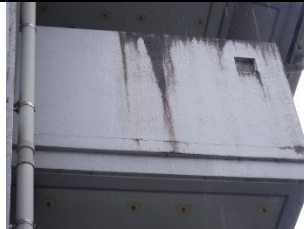
ひび割れ・汚れの付着
