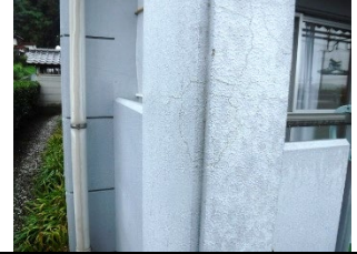
外壁のひび割れ
