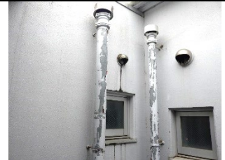
配管の塗装劣化
