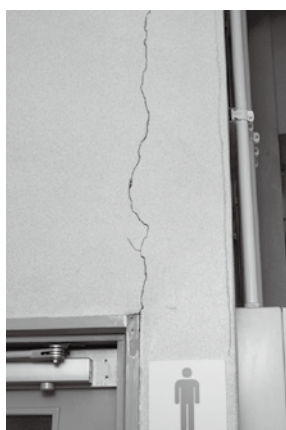
▲壁にあるひび割れ(旧庁舎)
