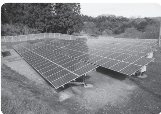
太陽光発電設備
