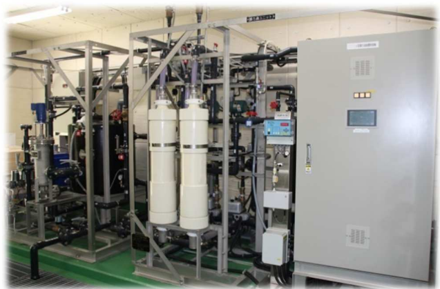
西野牧浄水場膜ろ過装置
