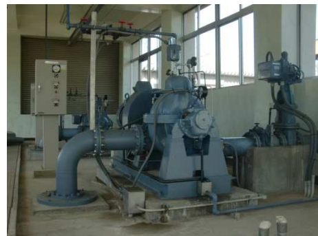
人見送水ポンプ 3 号
