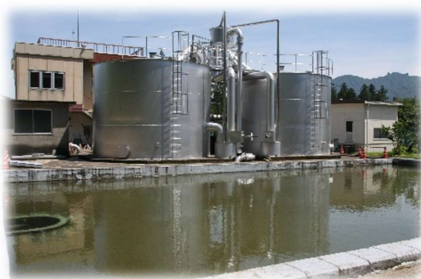
緩速ろ過池（手前）と急速ろ過機（奥）
