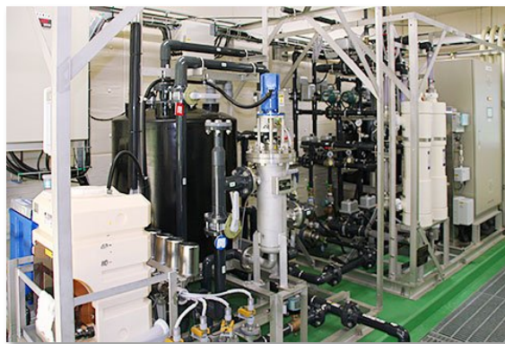
西野牧浄水場膜ろ過施設
