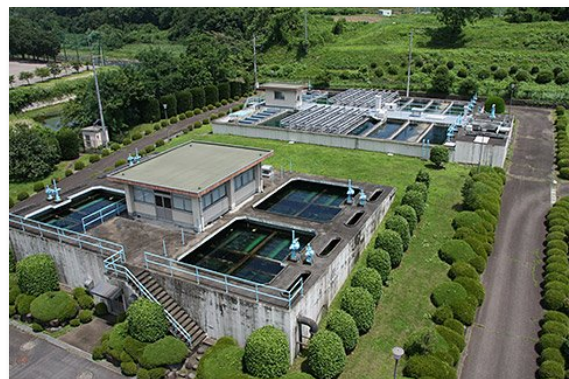
急速ろ過池（手前）と沈殿池（奥）
