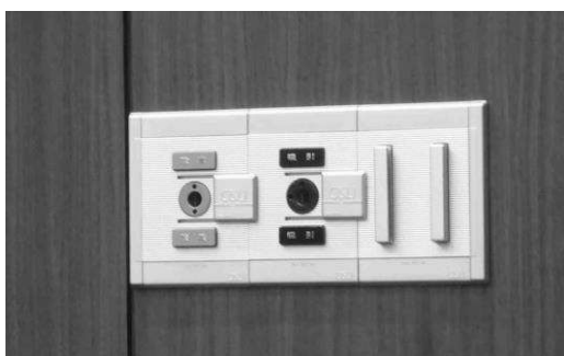
会議室の壁に医療ガス設備
