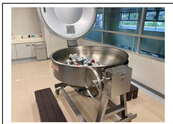
設置したガス回転釜
