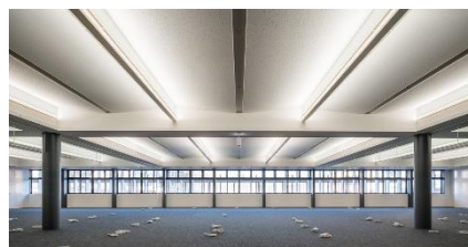
空調・照明を一体とした例（上田市役所）
