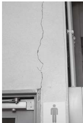
▲壁にあるひび割れ(旧庁舎)
