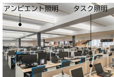
タスクアンビエント照明の例 (上田市役所)
