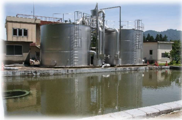
緩速ろ過池(手前)と急速ろ過機(奥)
