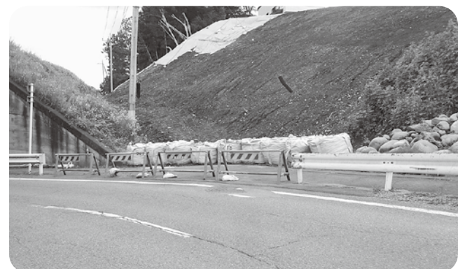
安中中央体育館西側のり面が一部崩落
