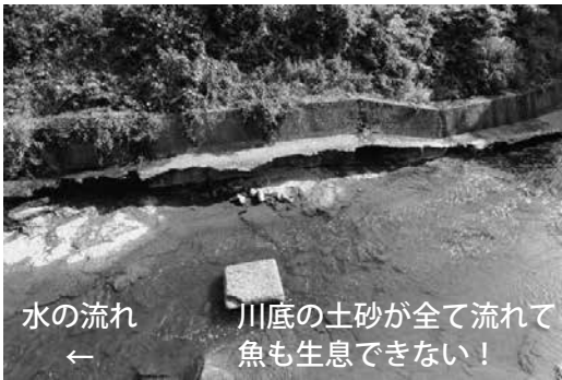
浸食された川底の状況
