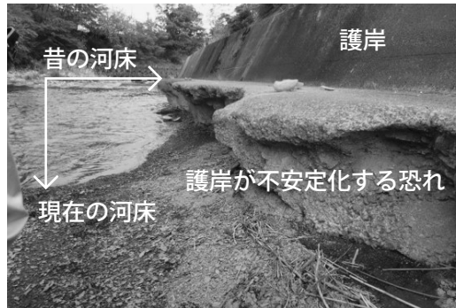
護岸が浸食された状況
