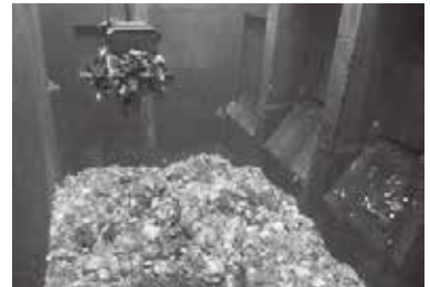
▲ごみ貯留ピット
