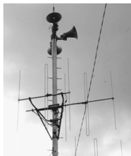
電波状況の悪い地域に設置された 再送信子局
