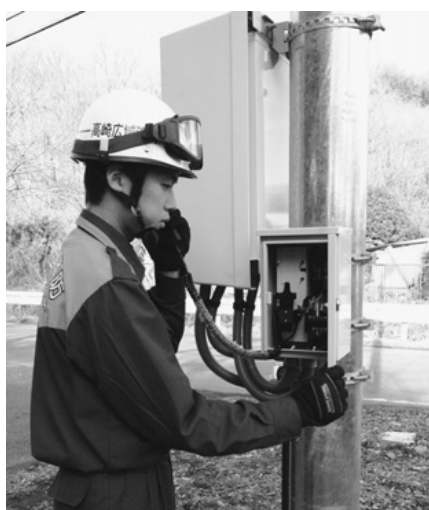
市内 33 カ所に設置された アンサーバック付きの屋外子局
