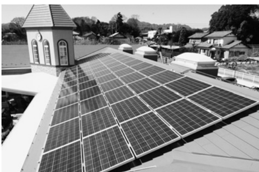
▶屋根に設置された太陽光パネル
